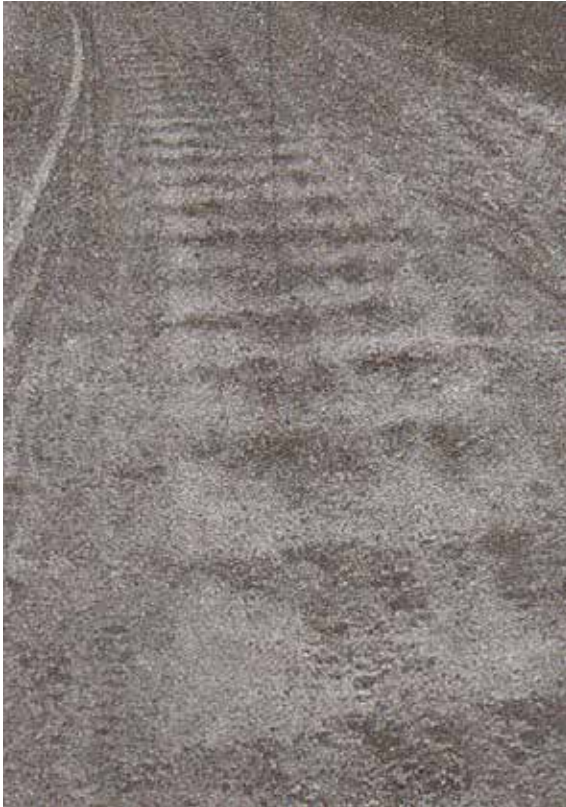
Poikittainen kouruuntuminen eli nimismiehen kihara on soratien perusviitsaus, joka lannistetaan tiehöylällä. Kuva teoksesta Suomen teiden historia II.
