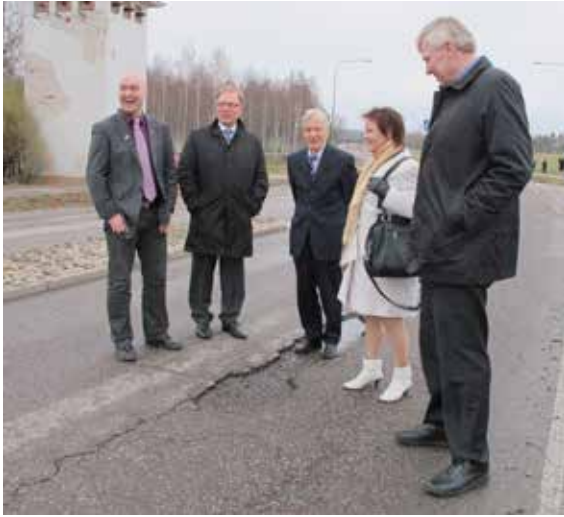
Vuonna 2012 Auto- ja Tieforum järjesti kansanedustajille ja median edustajille huonokuntoisten päällysteiden katselmuksen.
