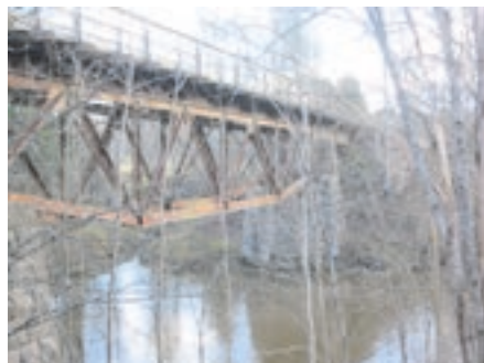
Viime vuosisadan alussa rakennettu silta toimi rautatiesiltana vielä 1980-luvulla, jonka jälkeen vilkkaan yksityistien siltana. Teräsrakenteen pintakäsittelyyn on syytä hakea Leader-rahautusta.
