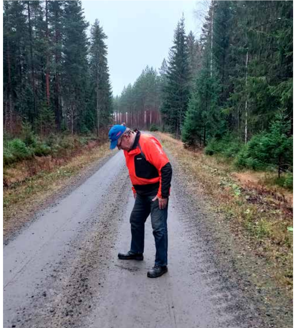
➤ Hoitokunnan puheenjohtaja Leo Väreleä on tyytyväinen vuosi vuodelta tiivistyneeseen tien pintaan. Sadevedet eivät painu tienrunkoon, vaan valuvat sivuoihin.
