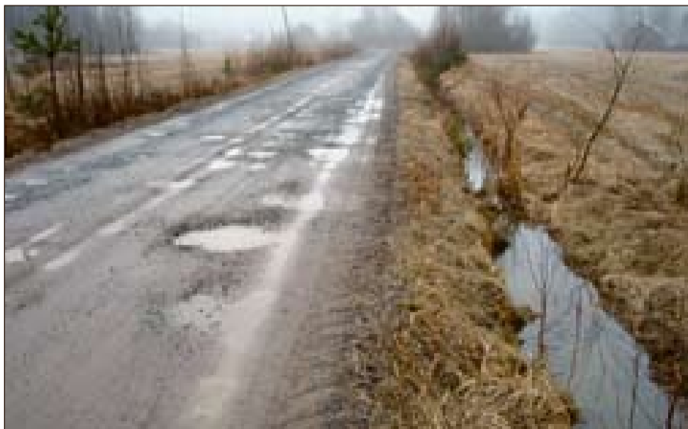
Tyypillinen näky yksityistiellä, vesi seisoo tiellä ja ojassa, tien kantavuus ei enää riitä. Jatkuva kunnossapidosta ei ole huolehdittu, ja nyt on edessä rankempi ja kalliimpi peruskorjaus.
