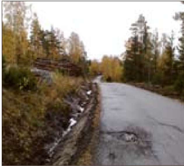
Tien kuivatusjärjestely on osaksi toteutettu. Huonokuntoinen päällyste odottaa ABK-käsittelyä.
