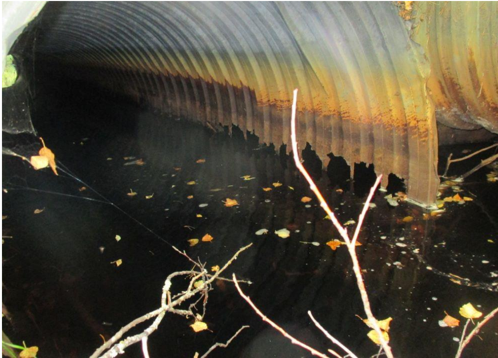
Kuva 14. Hapan vesi saattaa ruostuttaa teräsputken jopa 15–20 vuodessa. Nykyisin teräsputkiin on saatavilla suoja-aineita ruostumisen estämiseksi. Kuva: Veikko Heikkinen.
