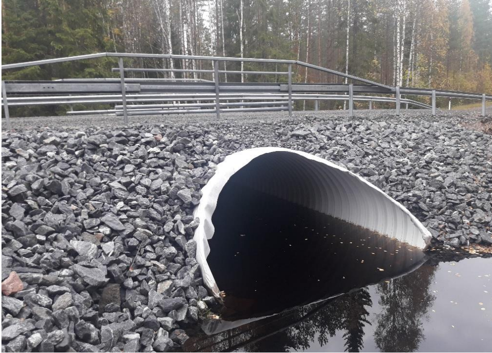
Kuva 34. Putkisilta, kaiteet ja luiskien verhoilu on saatu valmiiksi. Huomaa, että isojen putkien ja putkisiltojen päät viistetään sopivaan luiskakaltevuuteen esim. 1:1,5. Tämä silta on nyt valmis palvelemaan tieosakkaita ja muita tienkäyttäjiä pitkälle tulevaisuuteen. Kuva: Veikko Heikkinen.
