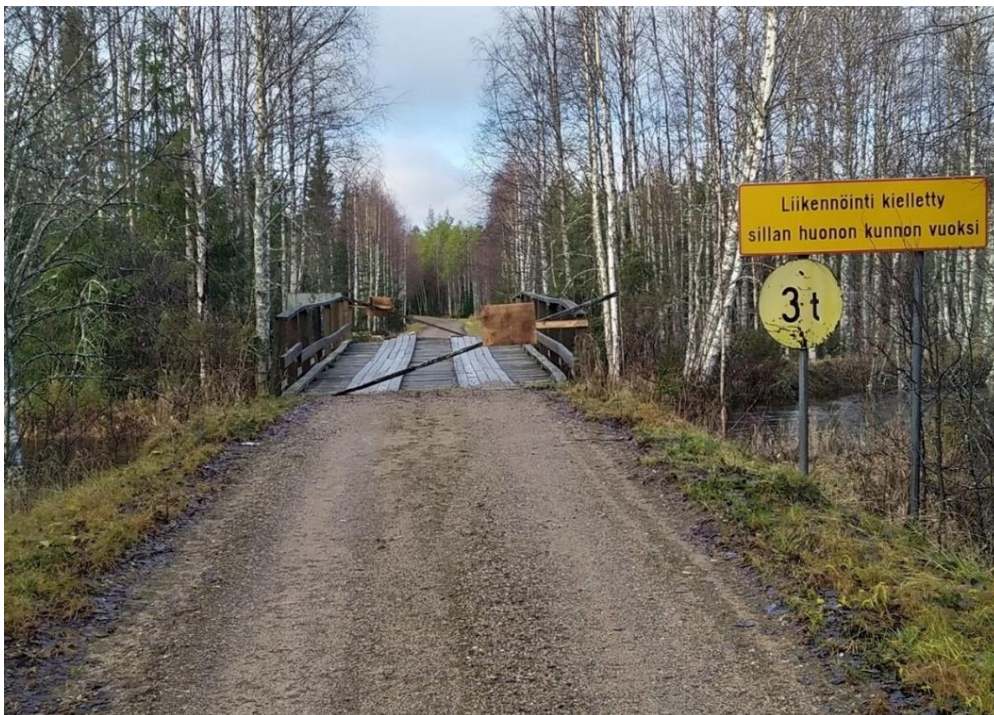
Kuva 19. Yksitystien silta on suljettu heikon kunnan vuoksi. Kuva: Timo Pisto
