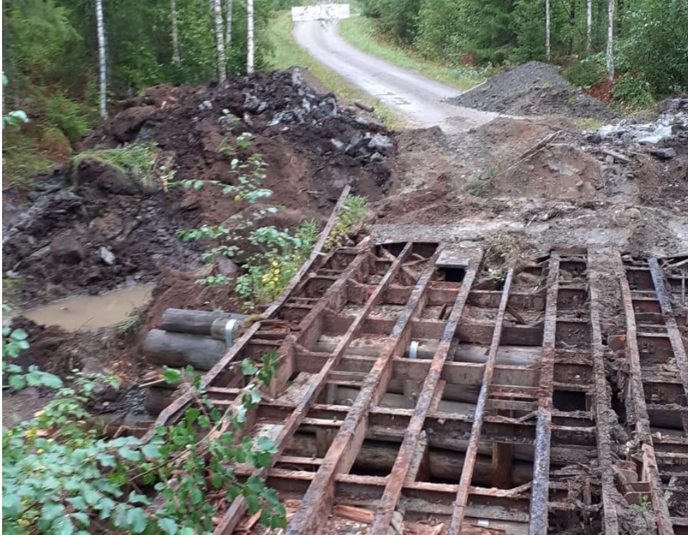
Kuva 31. Kansirakenteita on purettu ja niiden alta on paljastunut pahoin ruostunut junanvaunun runko. Kuva: Veikko Heikkinen.
