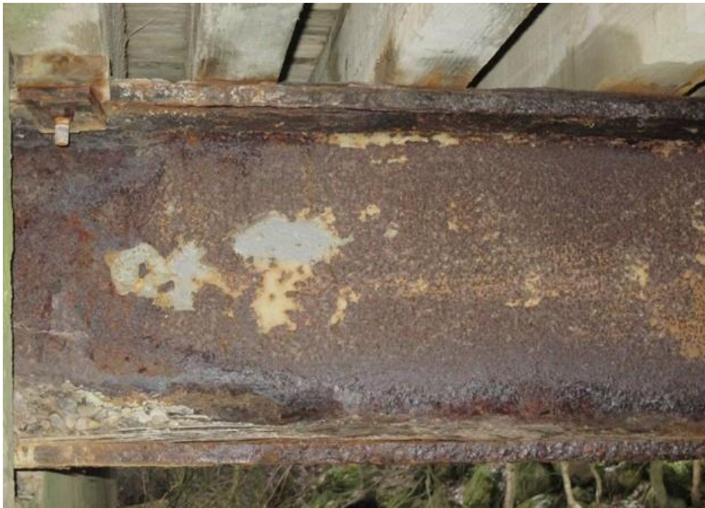
Kuva 11. Korroosion vaurioittama teräspalkki. Kuva: Veikko Heikkinen.
