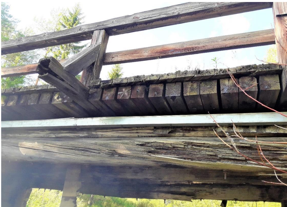
Kuva 13. Lahovaurio koko päällysrakenteessa. Kyseinen rakenne ei ole enää korjattavissa vaan se on uusittava. Kuva: Veikko Heikkinen.
