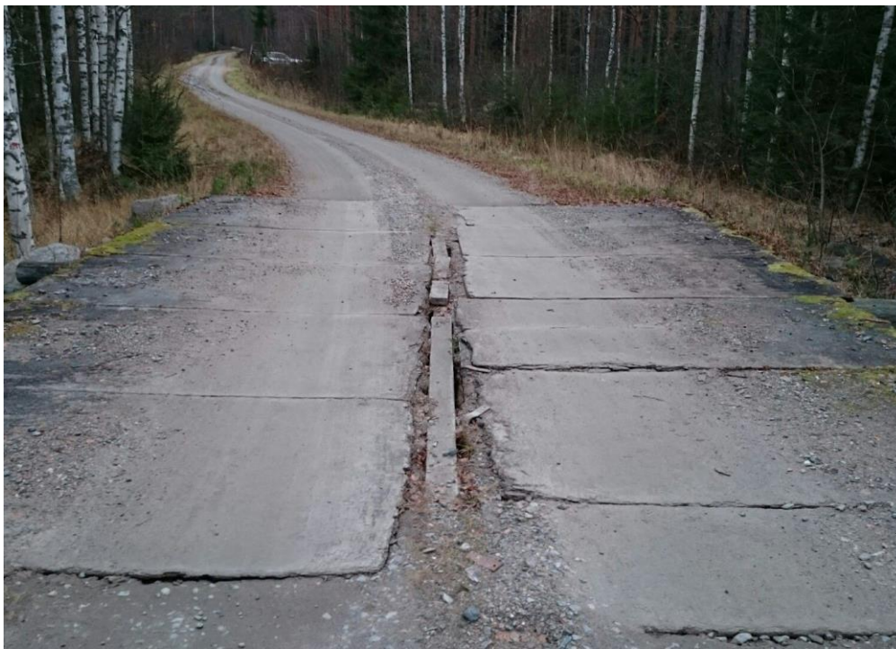
Kuva 29. Kaiteet puuttuvat ja kansi on huonokuntoinen. Kuva: Veikko Heikkinen.
