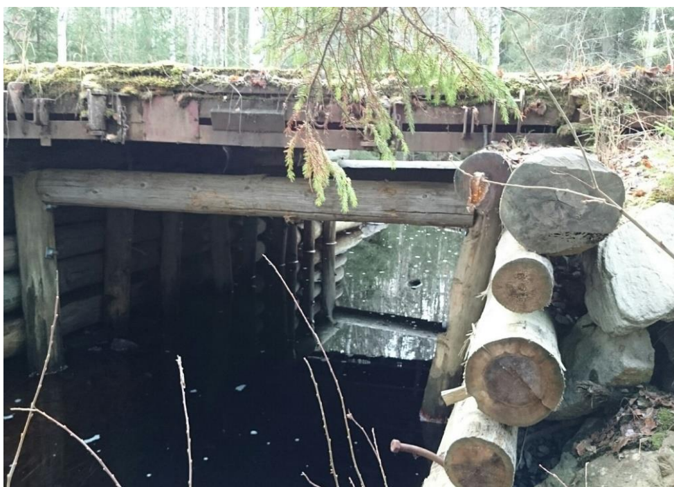
Kuva 30. Myös maatuissa ja perusrakenteissa on jo vaurioita. Kuva: Veikko Heikkinen.
