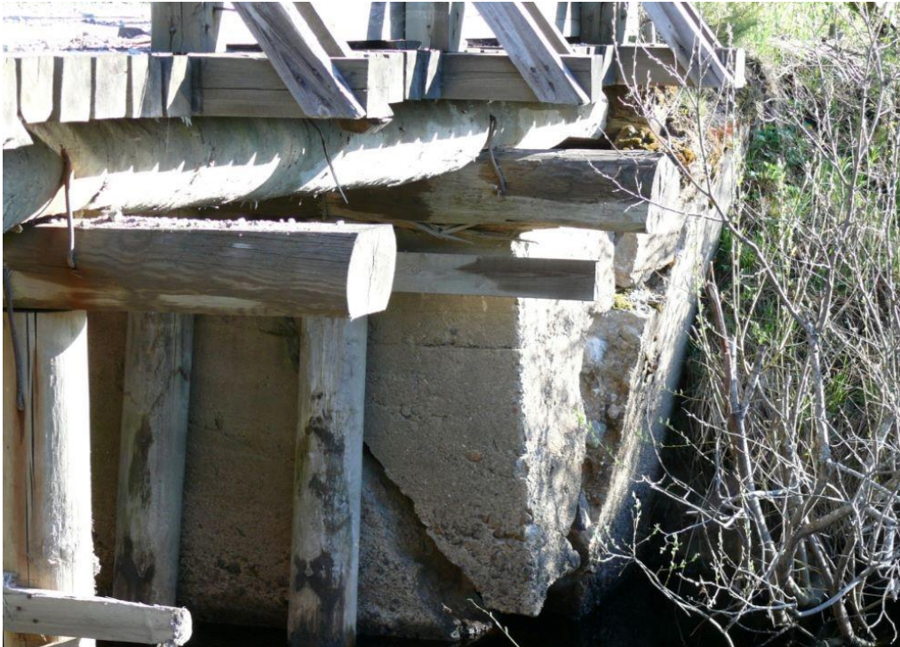
Kuva 12. Betonisen perustuksen halkeama- ja siirtymävaurio. Kuva: Veikko Heikkinen.
