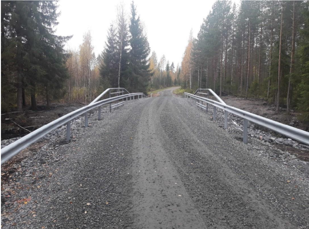
Kuva 35. Sillankaiteiden lisäksi on uusittu myös pengerkaiteet. Nykyisten suunnitteluohjeiden mukaiset ja riittävän pitkät kaiteet lisäävät liikenneturvallisuutta. Kuva: Veikko Heikkinen.
