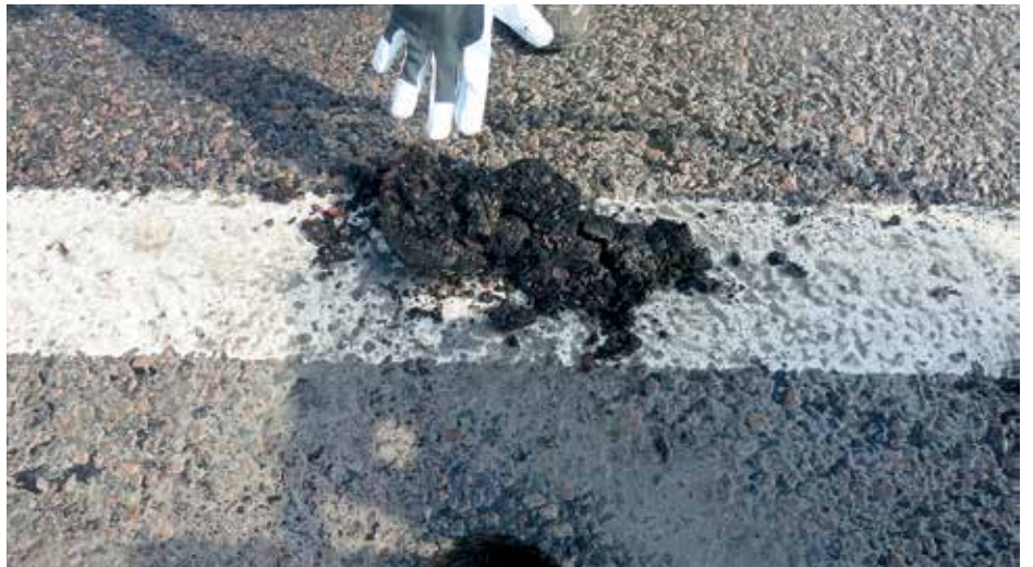
Huonokuntoinen suoja-asfaltti Luhtaanmäellä.
