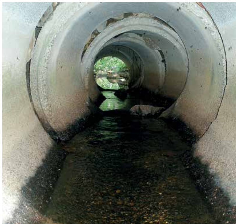
Kiireellistä uusimista tai perusteellista kunnostusta vaativa rumpu. Siderautojen puuttumisen takia putket ovat päässeet liikkumaan.
