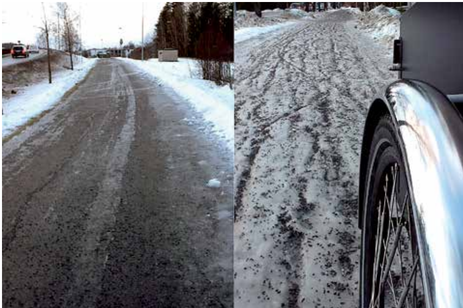
Pirkkalassa (vas.) aurattiin perjantaina 16.1. ja seuraavana päivänä väylät olivat huippukunnossa. Tampereen puolella (oik.) kunnossapito jätettiin tekemättä ja olosuhteet olivat pyöräilijöille ja kävelijöille äärimmäisen vaaralliset.
