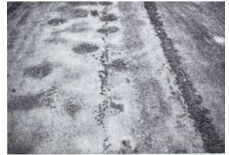
Kuva 4. Sadeveden turmelema tiepinta ei ole parantunut höyläämisestä.
