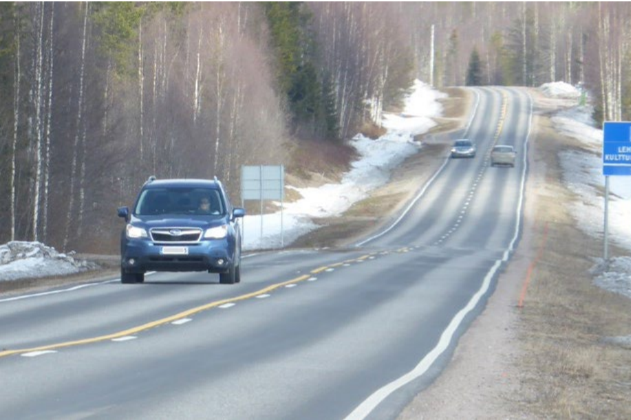
Kuva 7. Myöhästynyt palteiden kaato ja sohjo-ojien teko aiheuttavat lumesta sulavan veden imeytymisen päällysteen alle, jossa jäätyy uudelleen ja muodostaa jäälinsejä ja epätasaisuutta päällysteen reunassa.
