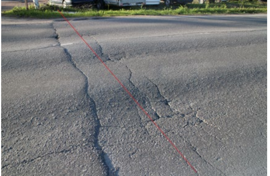
Kuva 1. Kaukolämpökaivanto routivalla katuosuudella aiheuttaa heiton ja halkeamat päällysteeseen. Myös kaivannon tiivistyksessä havaittiin puutteita.
