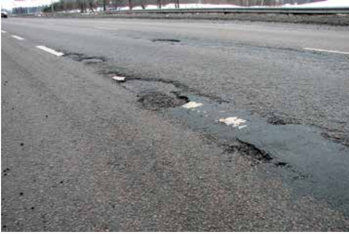
Kuva 2. Purkautuvaa keskisaumaa ja reikiä päällysteessä.
