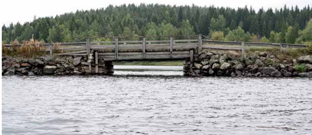
Vanhan sillan kansi oli kallistunut tukirakenteiden petettyä.
