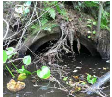
Pehmeään maaperään huonosti perustettu ylitysrakenne täyttyy helposti lietteellä ja alkaa kerätä kariketta ja vesikasveja. Mitä syvemmälle rakenne painuu, sitä huonompi on vedenvaihto ja karikkeen keräämistaipumus.
