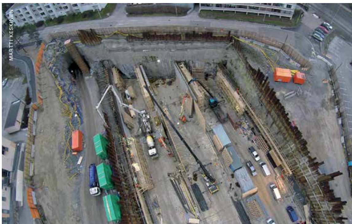
Läntisen suuaukon betonitunneliosuus rakennetaan samanaikaisesti tunnelilouhinnan kanssa. Vasemmalla näkyy työtunnelin suuaukko, josta nousee työnaikainen imuilma piippu. Tuulettajat on sijoitettu melun vuoksi maan alle työtunneliin. Vihreät kontit vasemmassa alakulmassa ovat poistoveden saostusaltaita, joista kiintoaines toimitetaan imuautolla jätteen käsittelyyn ja vesi pumpataan jätevedenpuhdistamolle.
