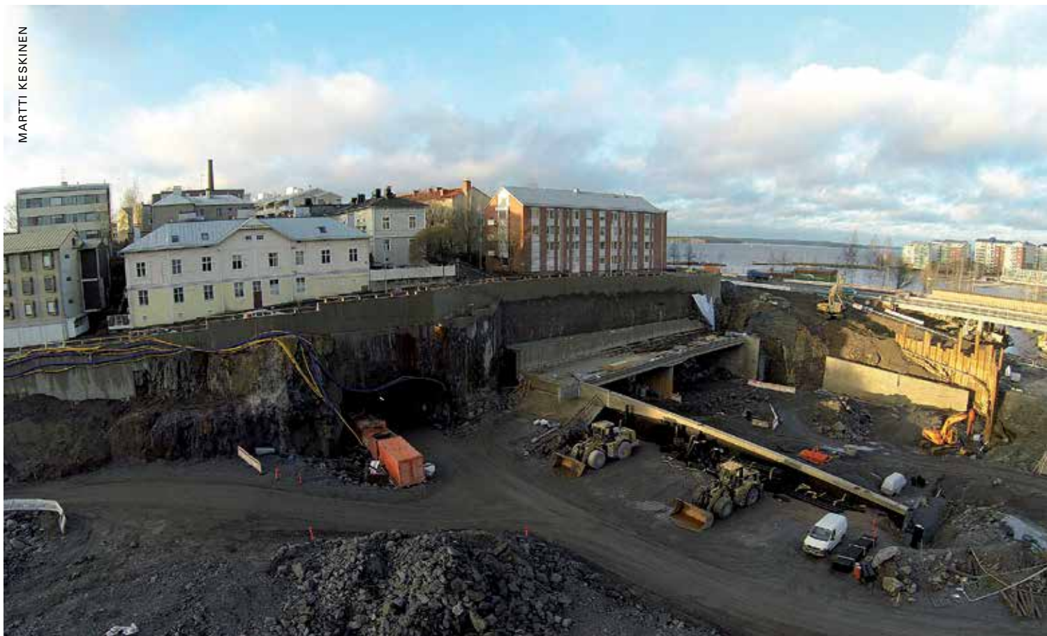
Itäinen suuaukko. Keskellä näkyy poistoilmatunneli johon tullaan sijoittamaan myös lopulliset poistoilmapuhaltimet sekä piipulle johtavat kanavat.
