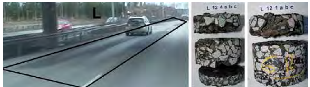
Kuva 3. Vasemmalla vaurioitunutta tietä, oikealla poranäytteet paljastavat, että päällysrakennekerrokset ovat irti toisistaan.
