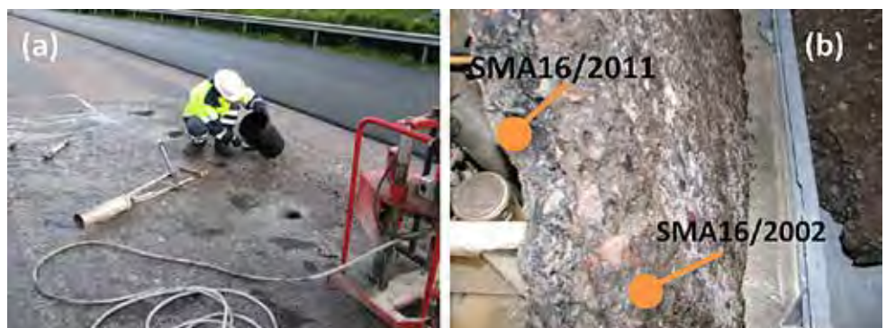
Kuva 1. Vasemmalla poranäytteiden ottoa ja oikealla tieltä otettu asfalttilaatta, jonka pohjassa on jäätä. Myös SMA16/2002 massan ruskea väri on selkeästi havaittavissa.
