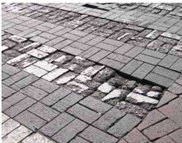
Betonikivetetty suojatie Myyrmäen terminaalissa. Kyseisessä kohdassa linja-autot kääntyvät Jönsäksentietä terminaaliiin. Kiveys on rakennettu 1990-luvun puolivälissä. Mustat betonikivet ovat säilyneet ehjinä, mutta valkoisten kivien pinta on pahasti kulunut.
