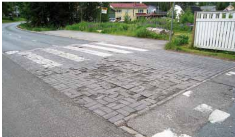
Kivikkotien korotetun suojatien hajonneita betonikiviä. Korotus on alun perin rakennettu vuonna 2005 ja kuva on otettu kesällä 2011. Vantaan kunnossapitäjien mukaan kiveys oli kulunut huonoon kuntoon jo alle kolmessa vuodessa.
