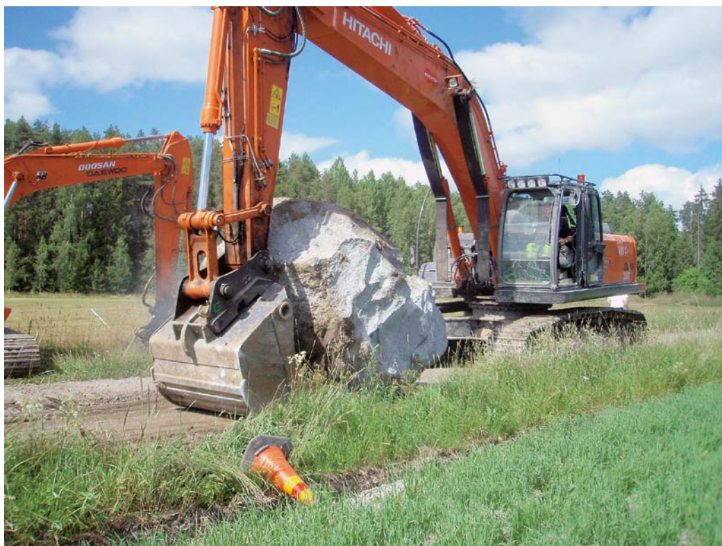
Tien perusparannuksen yhteydessä on varauduttava yllätyksiin – vanhasta tierakenteesta voi löytyä isoja, räjäytystä vaativia kiviä.
