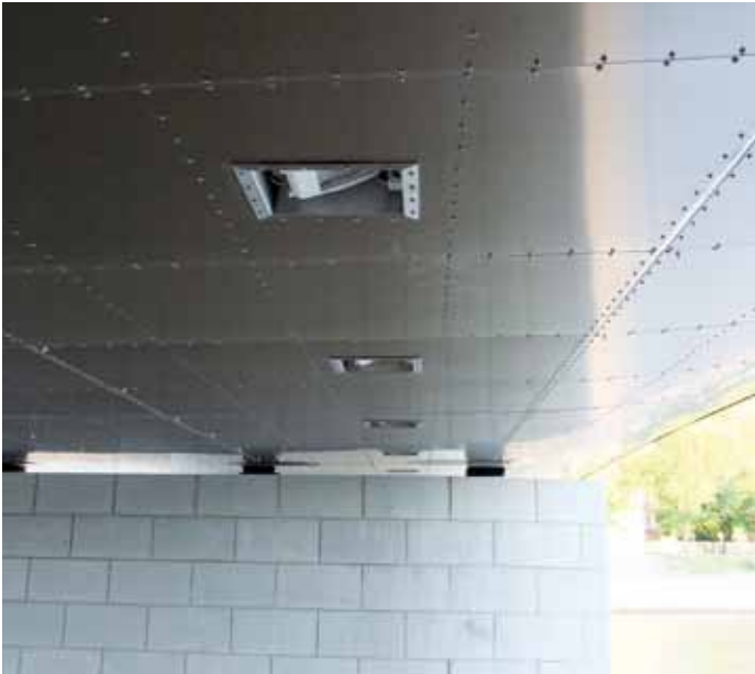
Sillan ohjelmoitava LED-valaistus on upotettu sillan alapintaan
