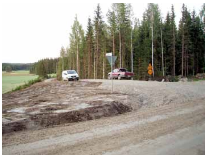
Uusi tielinja tehtiin kohtisuoraan kohti maantietä ja mäen päälle rakennettiin noin 25 metrin tasainen osuus. Runsas täyttömateriaali saatiin kunnan katutyömailta poistetuista ylimääräisistä maa-aineksista. Uusi tieosuus 125 metriä.
