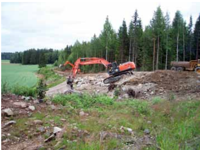
Liittymän siirto: Kuvan alaosassa näkyvä vanha tienosa liitettiin maantielle vaarallisessa mäessä, liittymäkulma oli terävä vasemmalle käännyttäessä ja näkemä huono.
