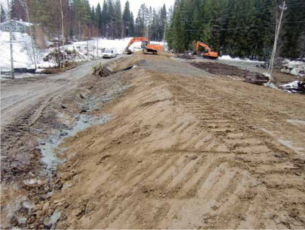
Siltanotkon oikaisu: Silta tehtiin vanhan sillan vie-reen, jolloin mutka saatiin oikaistua ja lähistöltä saata-valla soramoreenilla saatiin tie pengerrytettyä siten että vaarallinen mäki sillan luona loiveni. Uusi tieosuus 120 metriä.
