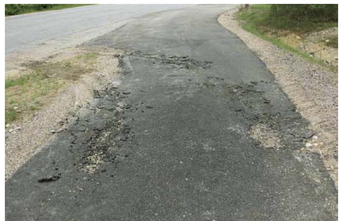
Kuvassa on erään rakennusbankeiden vastaanoton välitarkastuksessa todettu päällysteosuus, joka ei täytä ko. päällysteelle asetettuja laatuvaatimuksia. Sopimuksen mukainen päällystetyyppi ko. kevytväylällä on AB 16/100.
