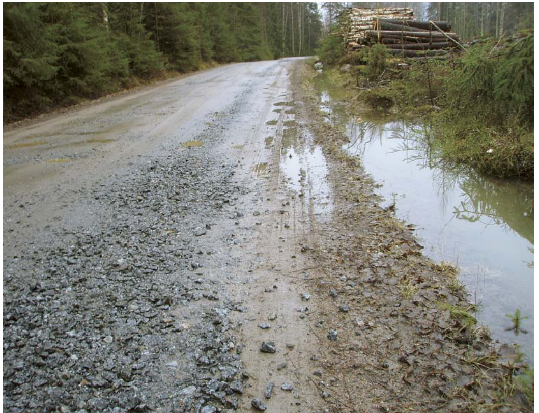
Rumpu on tukossa ja vesi nousee tielle.
