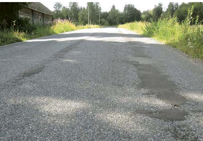
Pabimpia purkautumakohtia on jo jouduttu paikkailemaan.
