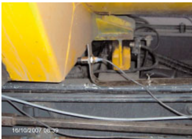
Kuva 3. Rajakytkin asennettuna lavan alle.
