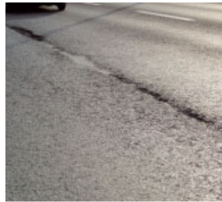
Erityisen herkeiksi vaurioille ovat päällysteiden saumat, joissa pahimmillaan kulkee paikkaamista vaativa reikäjono.
