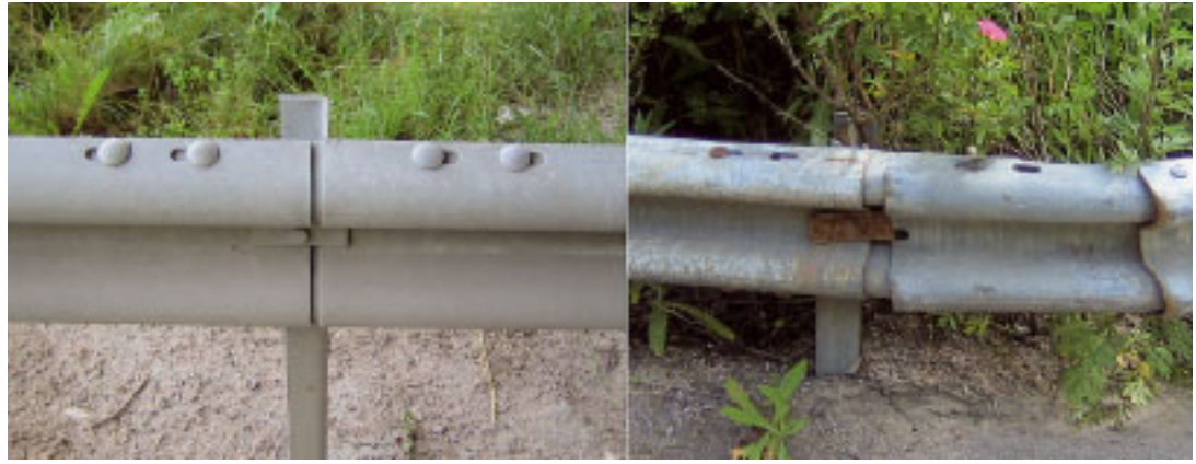
Esimerkki kunnossa olevasta ja puutteellisesta johteen jatkoksesta. Nuijamiestentie.
