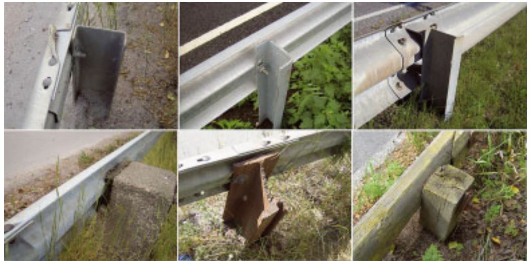
Tutkimuksessa inventoituja kaidetyyppejä vasemmalta ylhäältä: U-160-, U-100-, I-140-, betonipylväs-, urakisko- sekä puupylväskaide.
