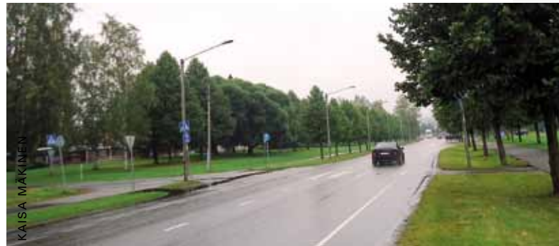
Suojatiemerkinnot ovat huonossa kunnossa ja erottuvat huonosti märestä asfaltista. Tien oikealla puolella oleva suojatiemerkki on jäänyt kasvillisuuden taakse piiloon.
