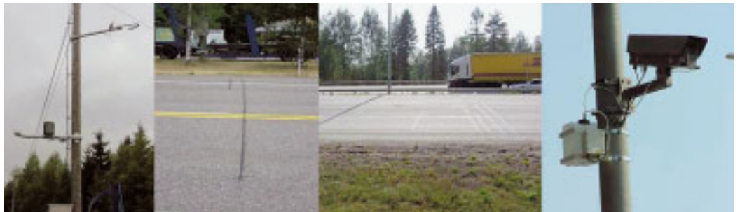
Valaistuksen ohjausjärjestelmä saa tietoa tiesääasemalta (kuiva/märkä tienpinta), liikennemittauksesta (ajoneuvoja/5 min, ajonopeus) sekä luminanssimittarilta (tien pinnan luminanssitaso).
