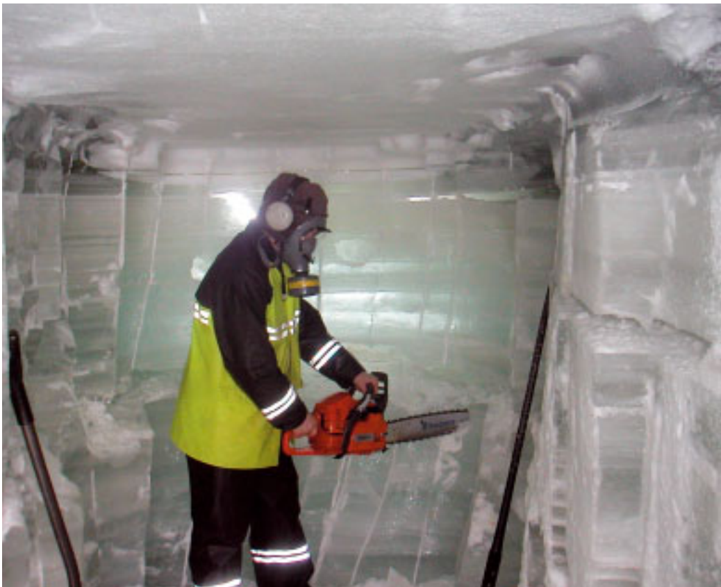
Paanteen tukkiman silta-aukon avausta. Tässä tapauksessa on myös työturvallisuus otettu huomioon. (Kuva Esko Raubala)
