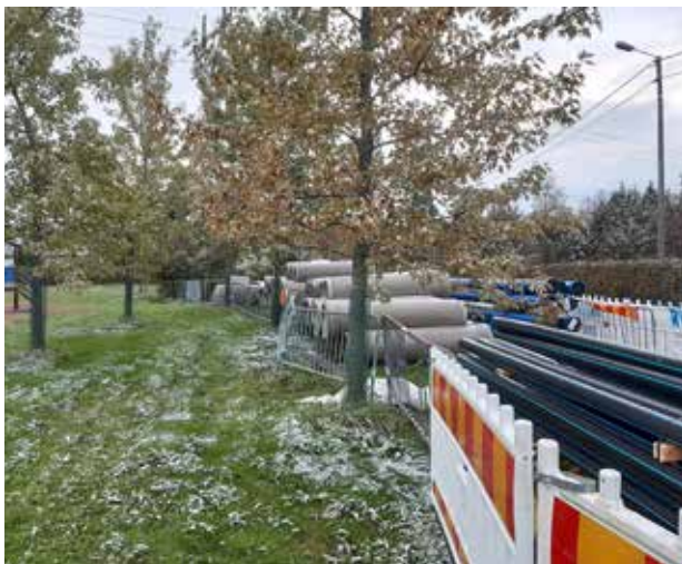
Vesihuoltotyömaan aitausta on laajennettu puiston puolella niin, että aidat ovat jo lähes kiinni nuorissa puissa. Tavaraa varastoidaan yhä lähemmäs puiden juuria ja paikoitellen niiden päälle.
