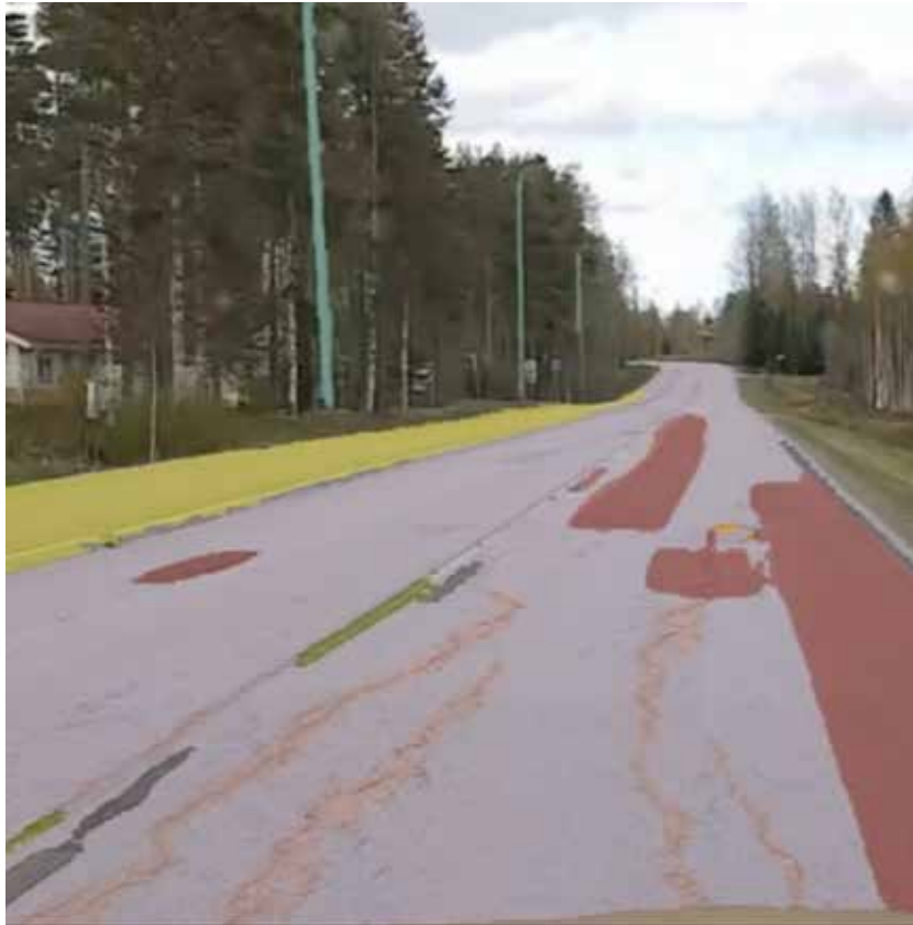
Vaisalan RoadAI-tekoälyjärjestelmä analysoi videoista esiin tiepäällysteen vauriot.
