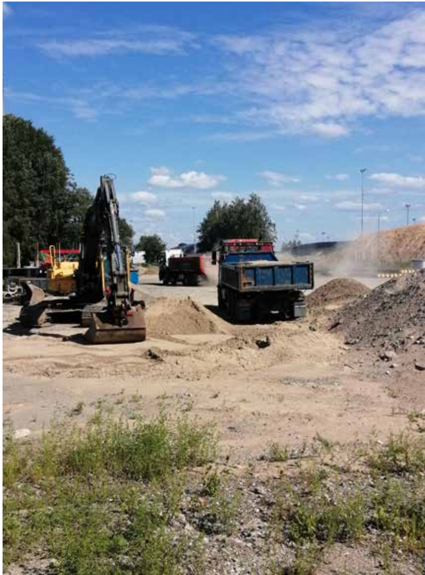
Vaarallisen näköinen, sekalainen kiviaineskuorma lähdössä peittämättömänä vilkkaalle Saaristokadulle Kuopiossa. Tavaksi on muodostunut, että sorakuormaa tasoitellaan hieman kaivinkoneen kauhalla.
